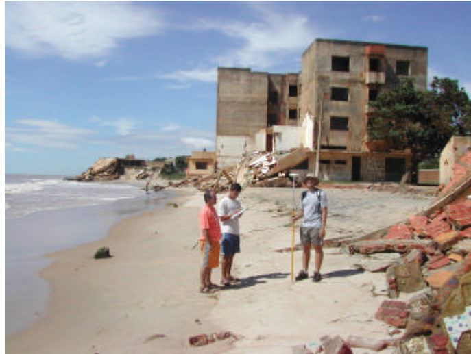
Fig. 5 – Fotografia indicativa de construção seriamente comprometida, condenada pela Defesa Civil: Hotel do Julinho.
